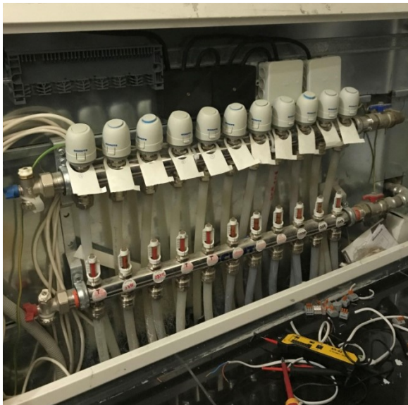
Zobrazenie servoventilov na jednotlivých okruhoch podlahového vykurovania
